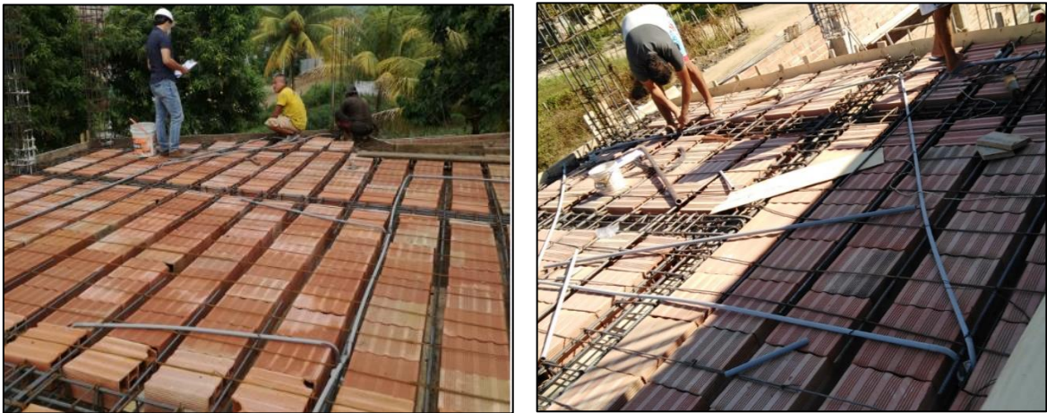
Figura 8. Instalaciones eléctricas en obras.
