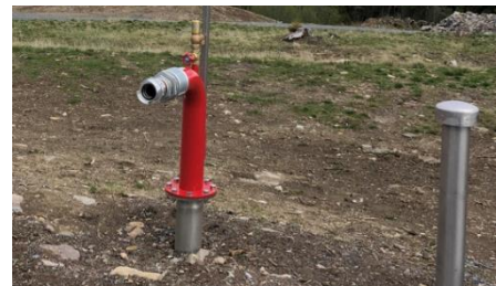
Figur 26. Brannhydrant med kapasitet på 20 l/s ved 6-7 bar tilkoblet en nedgravd lagringstank på 50 m 3 med kontinuerlig påfylling ved uttak. Systemet dekker brannvesenets brannvannbehov for 38 fritidsboliger i Bratholt Skog felt I og II. Foto: Jo Øverli Øyen
