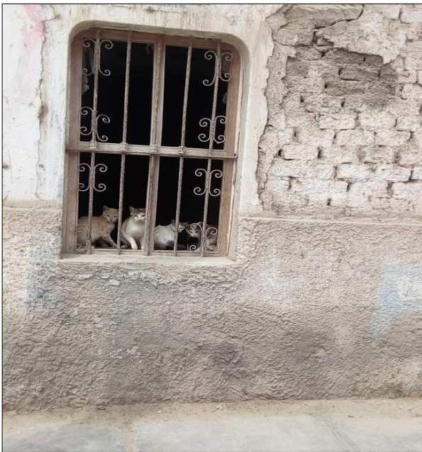
Anexo 06: Presencia de animales (gatos) en las viviendas abandonadas
