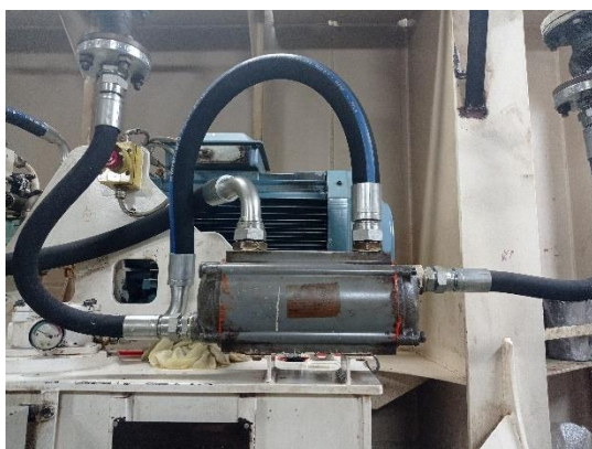
Figura 54 Enfriador aceite estabilizadores
