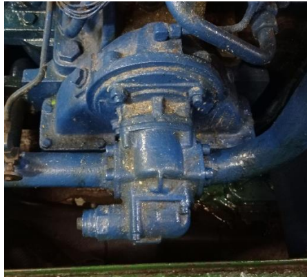
Figura 117 Bba acoplada reductora
