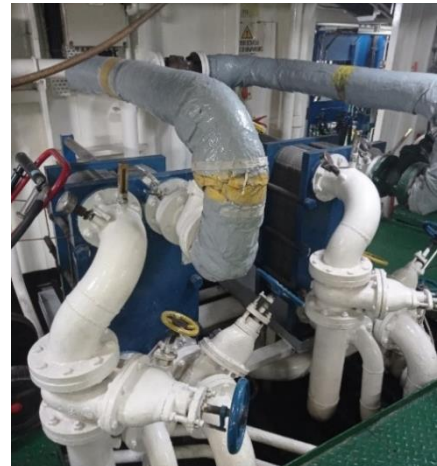
Figura 49 Enfriadores de aceite MMPP
