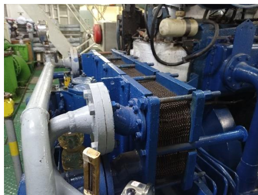
Figura 58 Enfriador de reductora
