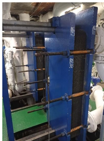
Figura 61 Enfriadores de agua salada
