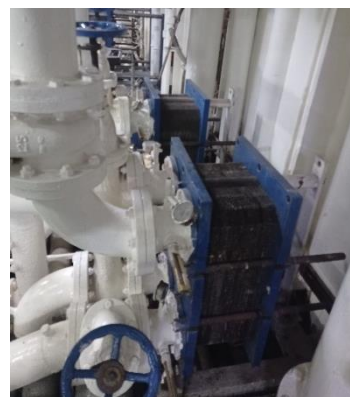
Figura 52 Enfriadores de AT
