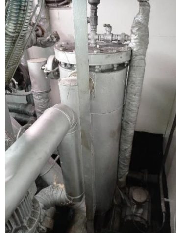
Figura 12 Tk. de mezcla
