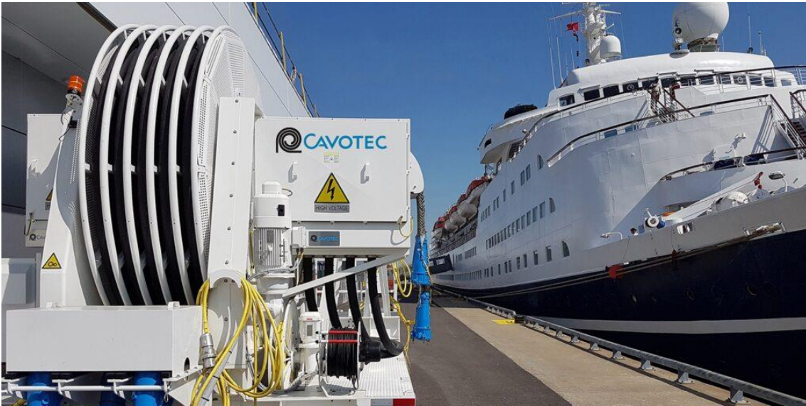
Figura 43: Instalación para dar electricidad a las embarcaciones atracadas en el puerto. Fuente: Portal web Cabotec.
