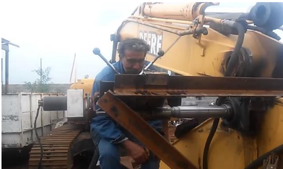
Figura 11. Operario sin EPP adecuados
