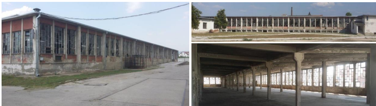
Слика 7.36 Фотографије актуелног стања испитиване бетонске хале у оквиру комплекса „Ђука Динић“ (извор: РАС - Развојна агенција Србије)
