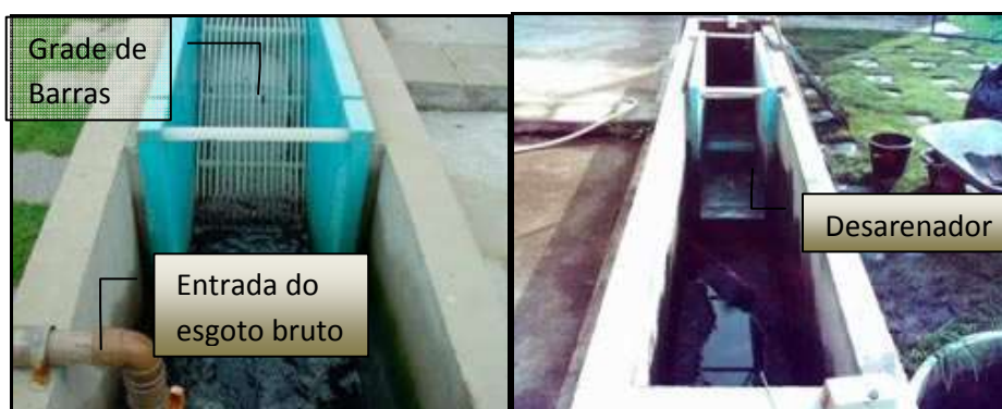
Figura 2.3: Tratamento preliminar do esgoto sanitário no CESA/UFRJ. Fonte: DRHIMA, 2012.
