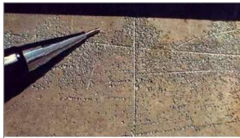
Figura II.4 - Corrosão por pite em aço inoxidável (GENTIL, 2007).
