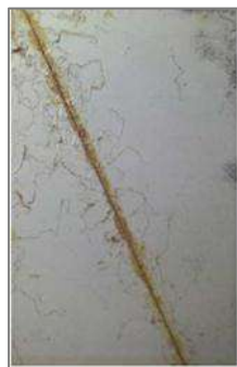
Figura II.7 - Corrosão filiforme. Filamentos se propagando em risco em chapa de aço (GENTIL, 2007).
