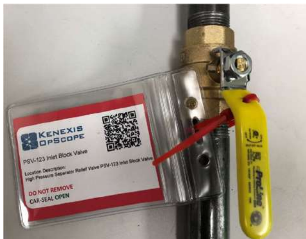
Figura 4.3 - Exemplo de bloqueio de válvulas em posição aberta.
