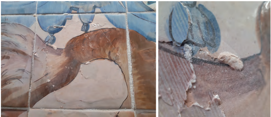
Fig. 15. Único ejemplo de azulejo con criptoflorescencias encontrado en 2021, donde se aprecia la presión de las sales entre el bizcocho y el esmalte, en el borde de las reintegraciones. Foto: Lucía Rueda Quero.
