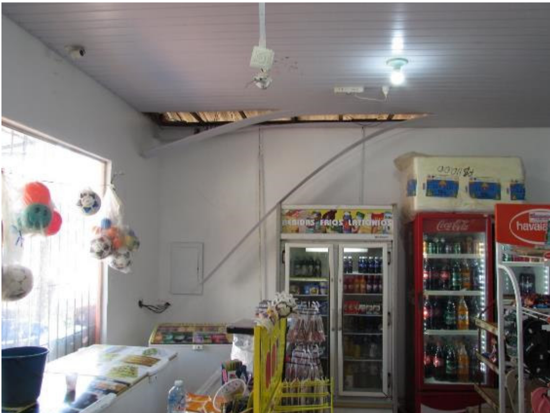
Figura 2 - Imóvel comercial submetido a arrombamento com acesso pelo telhado e forro. (Fonte: Arquivo Núcleo Policia Cientifica/Santana).
