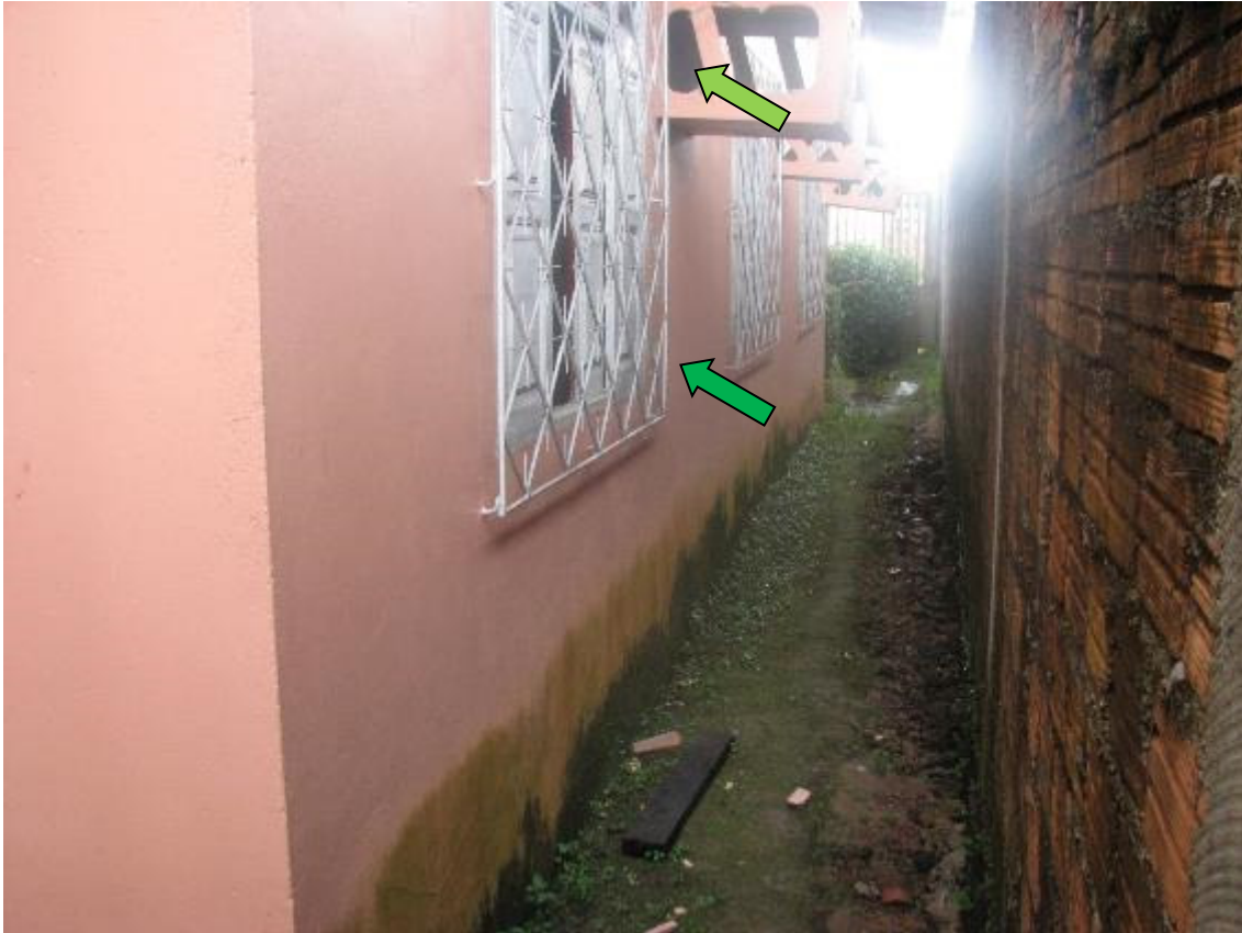
Figura 9 - Local de crime de Arrombamento, onde grade foi utilizada para escalar e acessar a estrutura do suporte do aparelho de ar condicionado (Fonte: Arquivo Núcleo Policia Científica/Santana).
