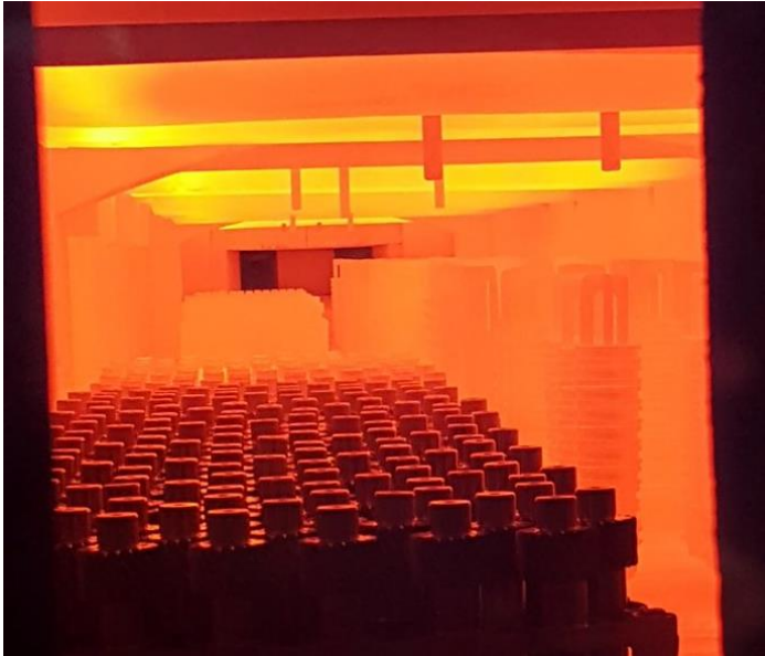
Abbildung 4-17: Blick in den Durchstoßofen mit neu eingetaktetem Werkstückträger
