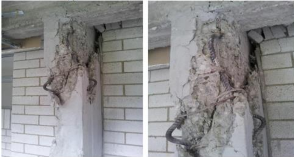
Figura 7. Fallo de columnas
