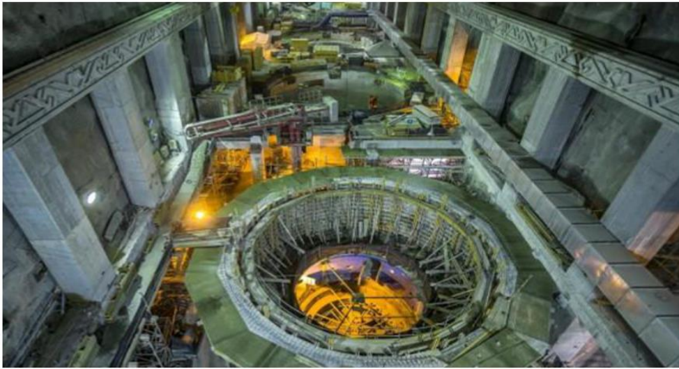
Figura 2. Casa de máquinas de Hidroituango.
