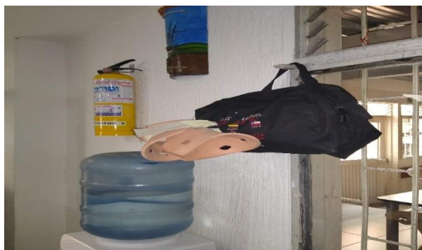
Figura 7. Extintor y botiquín mal ubicados.
