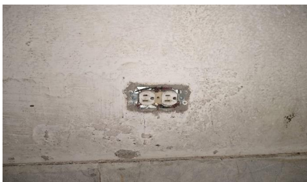
Figura 6. Tomacorriente en mala condición.
