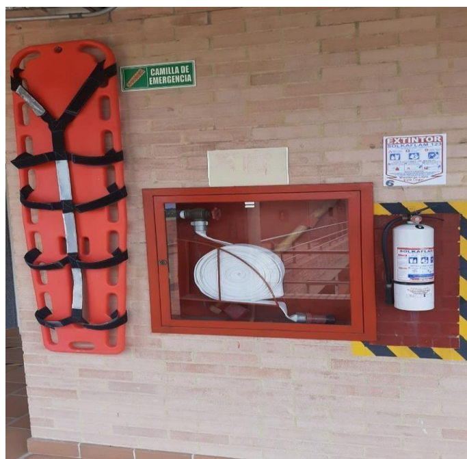
Figura 18: Equipos de emergencia
