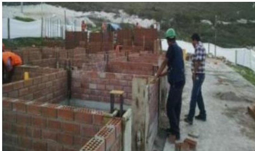
FOTOGRAFIA 4: Avance de obra actualizado al 11/12/2014. FUENTE: Página Web de INFOBRAS de La Contraloría.
