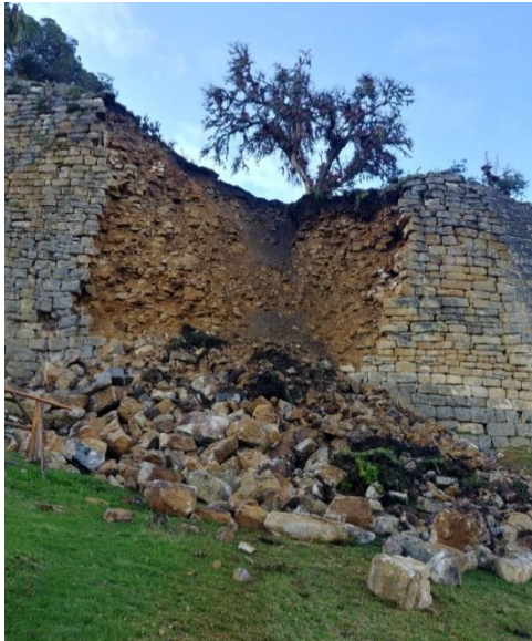
FOTOGRAFIA 17: Muro colapsado en Kuelap 10/04/2022. FUENTE: Ministerio de Cultura.
