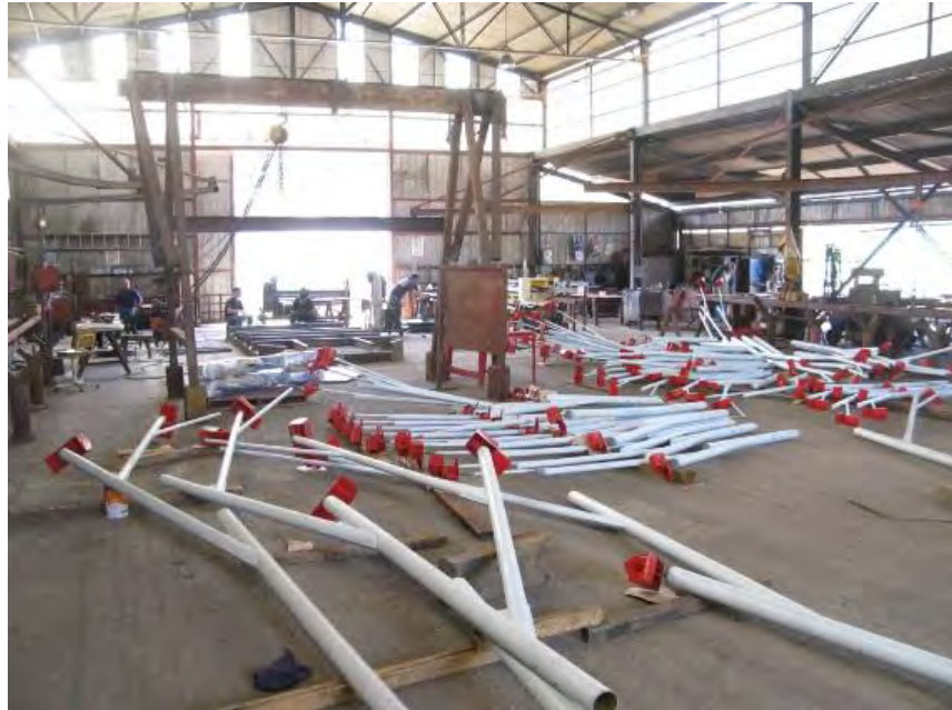
Figura N° 43. Construcción de los árboles de metal y los nidos en una nave industrial. Fuente: http://www.archivitamins.com/ecologic-bridge-for-birds-claudio-magrini-emilio-marin
