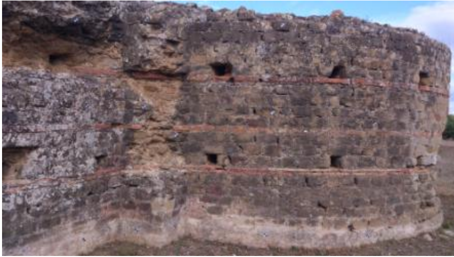
Fig. a.4. Saqueo y desmonte de secciones del paño de muro norte, así como del contrafuerte exterior que refuerza la unión entre el paño de muro y la exedra septentrional.
