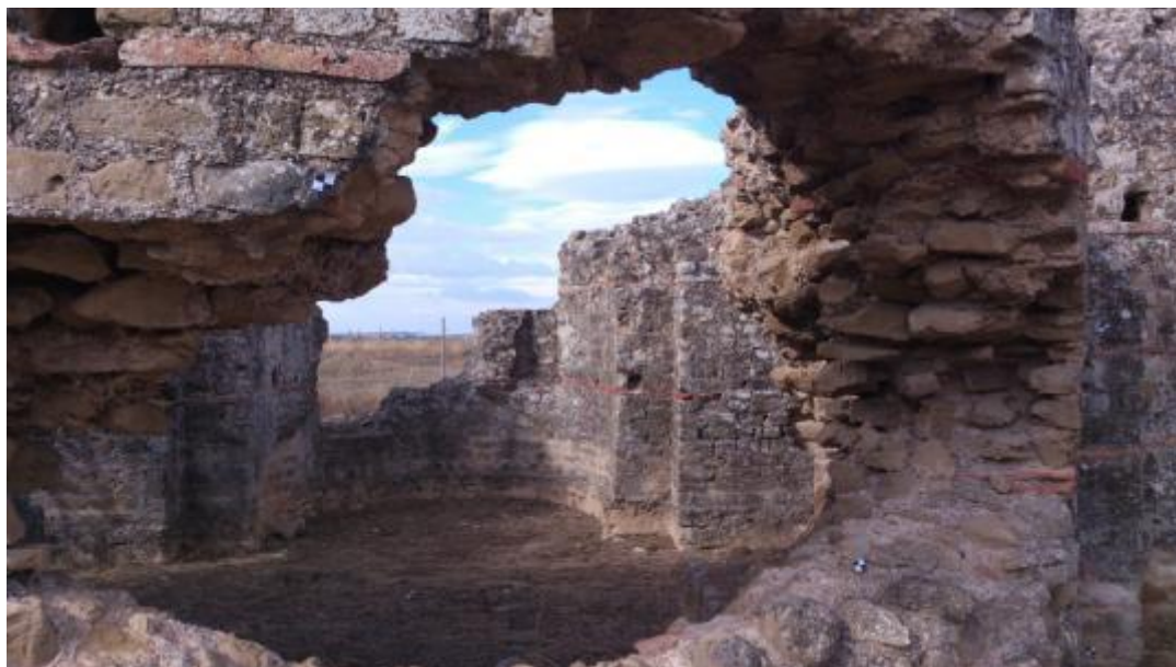
Fig. a.7. Daños estructurales graves del edificio: hueco en la exedra oriental del Mausoleo desde donde se aprecia la casi total eliminación del alzado de la exedra occidental.
