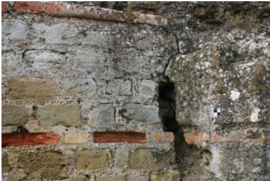
Fig. a.5. Grieta presente en la exedra oriental del Mausoleo.
