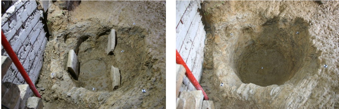
Fig. 2.- Agujero para alojar el poste de la prensa, vista con las piedras de calce (izquierda) y sin piedras (derecha).
