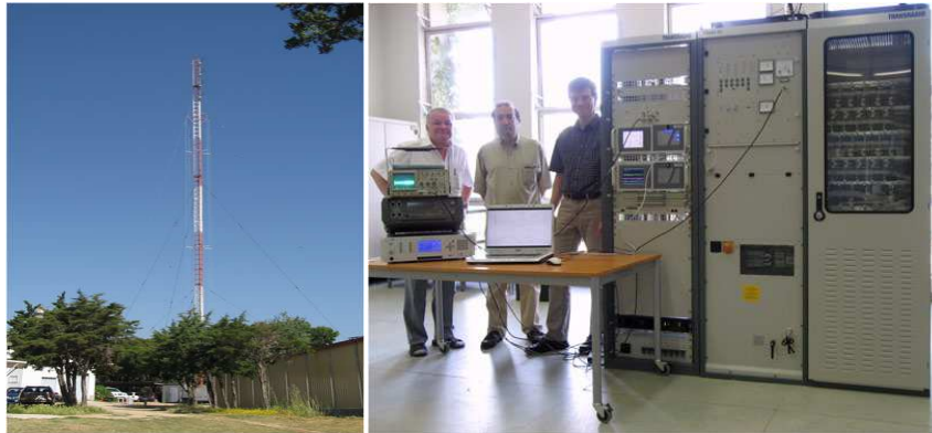
Figura 11. Estación transmisora en Onda Media de Pozuelo (Madrid).
