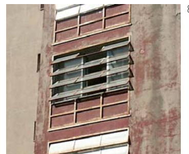
FIGURA 8 • Roma, ex "Casa Gil" a Trastevere. Dettaglio delle aperture sul fianco sud della torre dell'arengo; si notano l'aggiunta di un infisso supplementare all'interno degli ambienti e la tamponatura della fascia bassa dell'infisso originario, entrambe risalenti alla seconda metà degli anni novanta.
