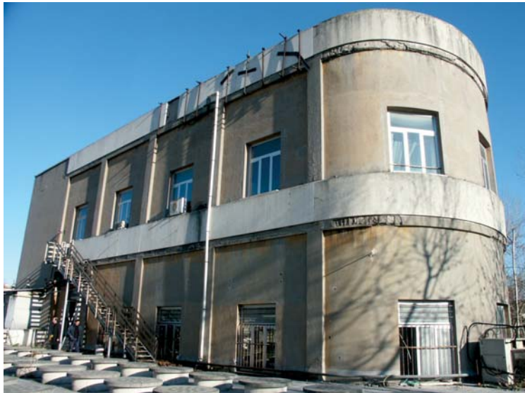
FIGURA 15 • Roma, ex "Casa Gil" a Trastevere. Dettaglio del corpo di fabbrica delle palestre en plein air . La modifica più incisiva consiste nella chiusura delle campate, un tempo aperte, fra i pilastri della struttura portante, cui si aggiungono il degrado del cemento armato e delle superfici intonacate, il distacco di alcune lastre di rivestimento del fascione sommitale e l'aggiunta maldestra di una scala antincendio.
