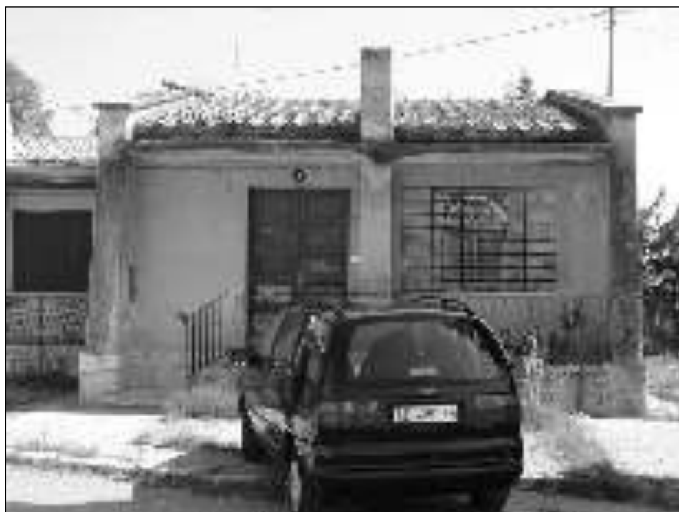
Fig. 6.56 - Borgo Serramarina (MT): Alloggio insegnanti – stato di conservazione
