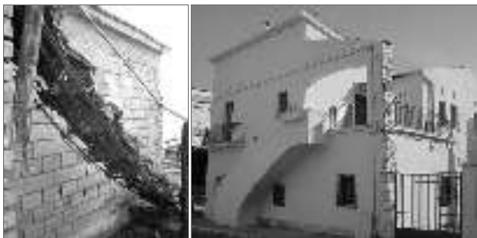
Figg. 6.64 e 6.65 – Degrado avanzato di una scala esterna in c.a. a borgo Signore (PZ) – Scala esterna a rampa unica a borgo Policoro (MT)
