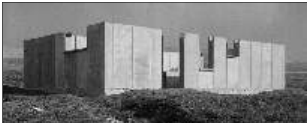
Fig. 6.21 - Campagne del Metapontino su SS 175 (MT) - Edificio prefabbricato: fasi di realizzazione - Archivio Buonsanti
