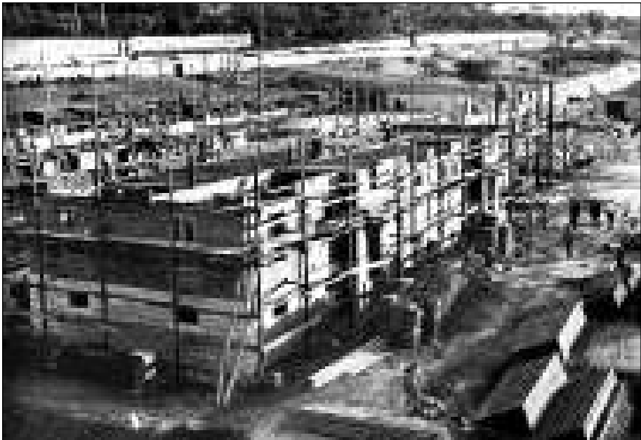
Fig. 6.29 - Borgo residenziale di Metaponto (MT) - Costruzione di un edificio con struttura mista, preparazione del solaio in laterocemento (1955) - Archivio Buonsanti
