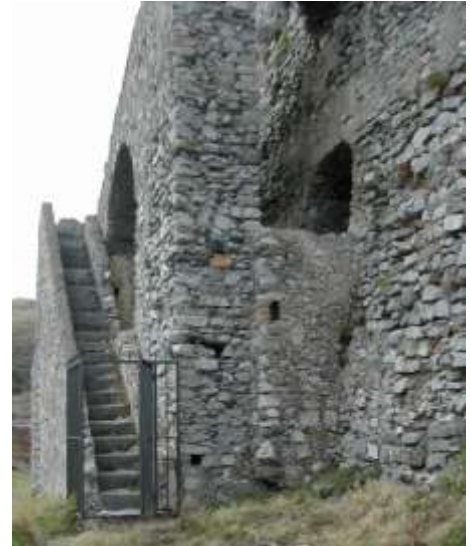
Fig.3.65 - Particolare della scala d'accesso a due rampe. Il livello intermedio è accessibile a metà della prima rampa, mentre il terzo livello alla sommità della seconda rampa.
