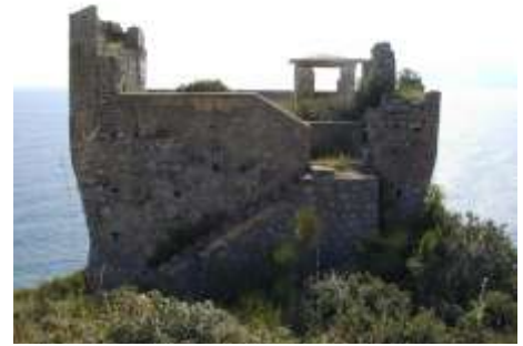
Fig.3.1 - Lato monte: sono visibili le superfetazioni della scala esterna e della garitta sulla piazza.
