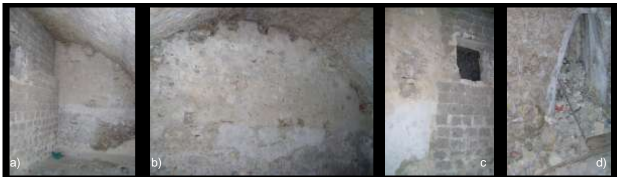
Fig.3.77 - Primo livello: a) muro di separazione tra la cisterna ed il restante piano; b) volta di copertura; c) apertura sulla cisterna; d) sbocco del cavedio nella cisterna.
