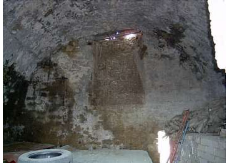
Fig.3.98 - Interno del primo livello. E' visibile la volta a botte di copertura e la finestra strombata sul fronte Nord-Est, così sagomata per consentire il passaggio delle scale nello spessore murario retrostante.
