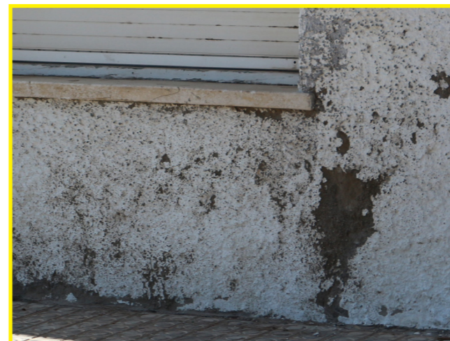
[23] Humedad por capilaridad en fachada Fuente propia
