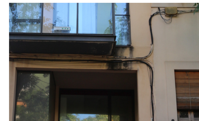
[29] Humedad por infiltración Fuente propia
