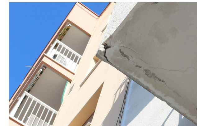
[28] Desprendimiento en esquina de balcón Fuente propia
