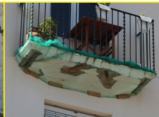
[24] Desprendimiento en balcones Fuente propia
