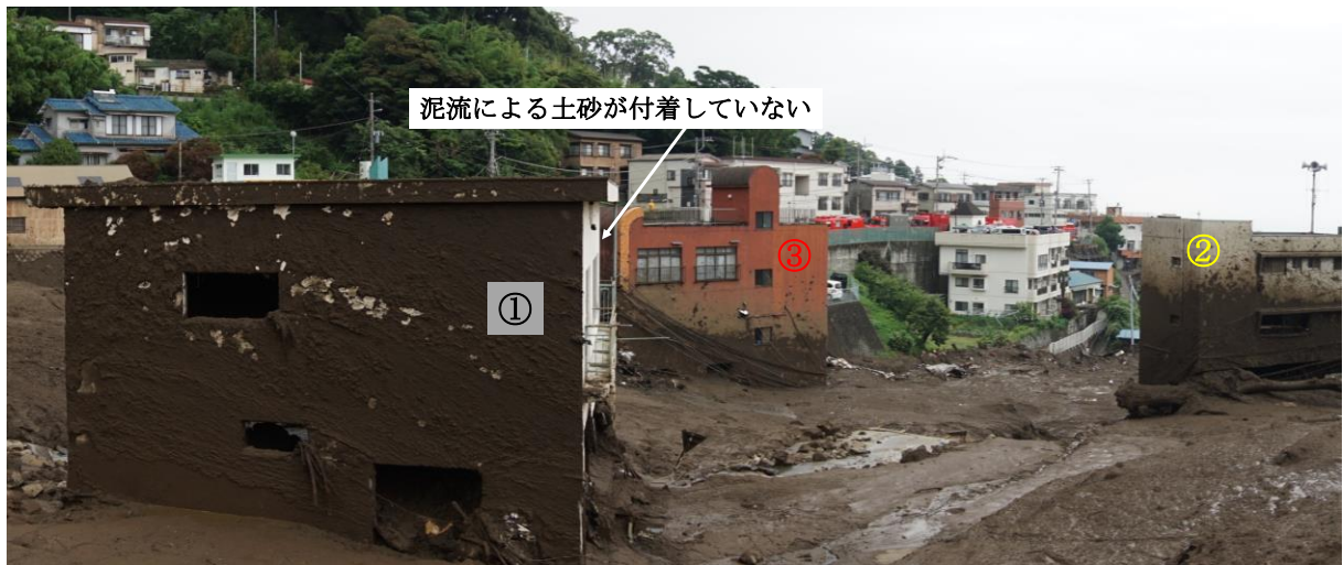
図-7 泥流流動域に残存した建物
