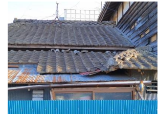
写真4 屋根瓦の被害
