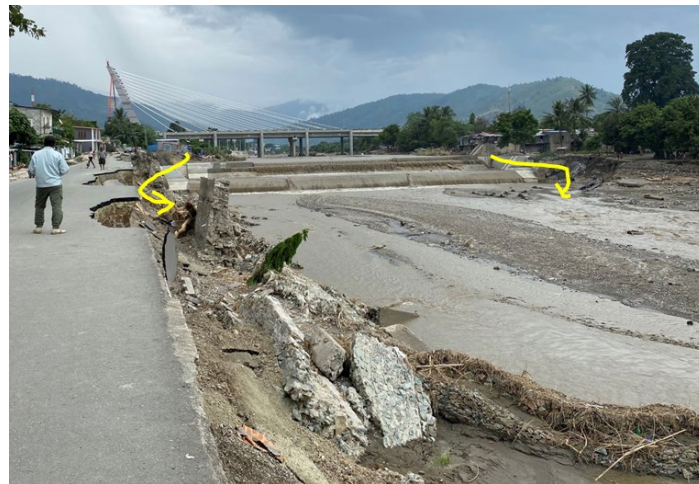
写真9 A-pointの被災状況（Comoro川）（4月8日撮影）
