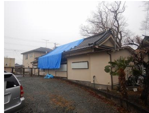
写真 55 瓦屋根の被害
