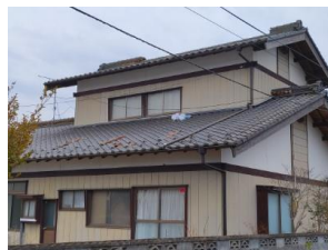
写真 35 瓦屋根の被害
