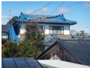
写真 47 瓦屋根の被害
