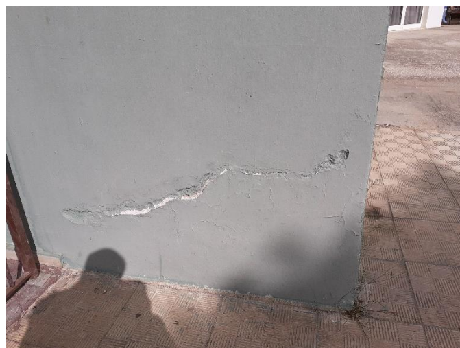
Εικόνα 1: Βλάβες στη σχολική μονάδα
