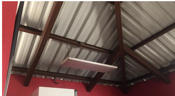
Figura 54. Luminaria en cocina
