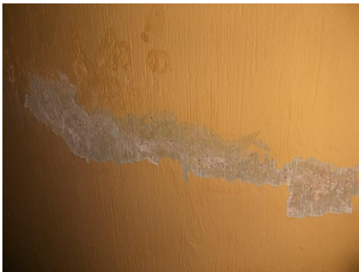
Figura 133. Muro con salitre
