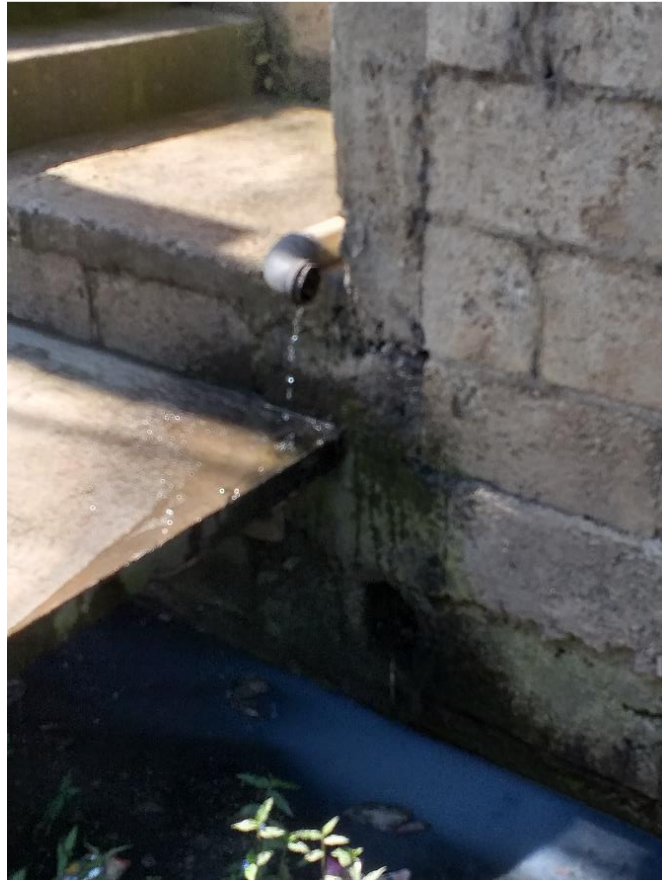
Figura 115. Goteo de aguas grises
