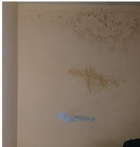
Figura 132. Humedad en muro
