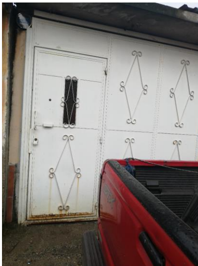
Figura 128. Óxido en puerta de metal
