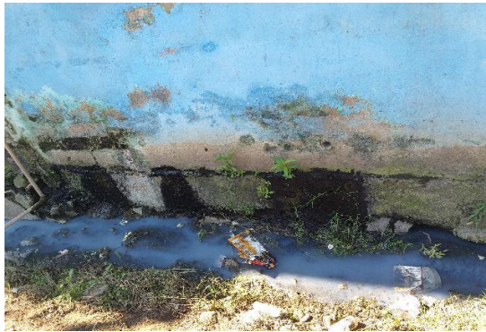
Figura 116. Aguas grises expuestas y humedad en muro
