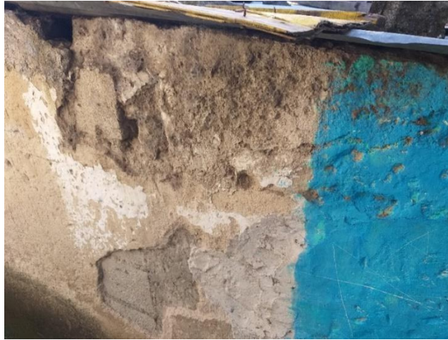
Figura 131. Desgaste de muro
