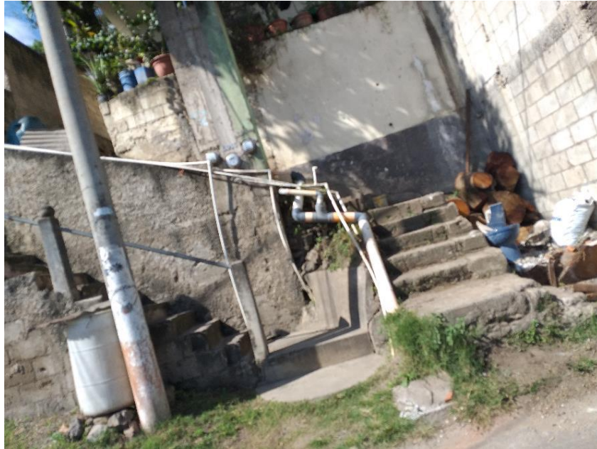
Figura 134. Tubería de PVC expuesta al sol
