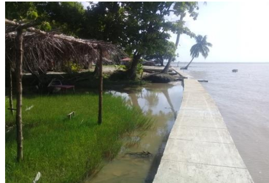
Imagen 3-17: estancamiento de aguas en muro de contención de la costa. Fuente: Br. Mariana Manzanarez.
