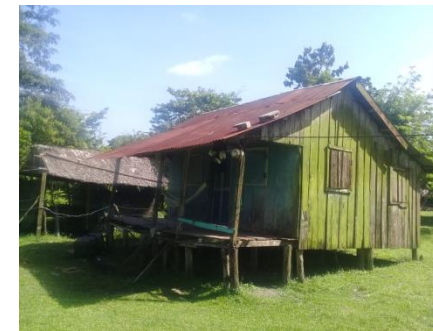
Imagen 3-24: vivienda sin condiciones mínimas de habitabilidad. Fuente: Br. Mariana Manzanarez.
