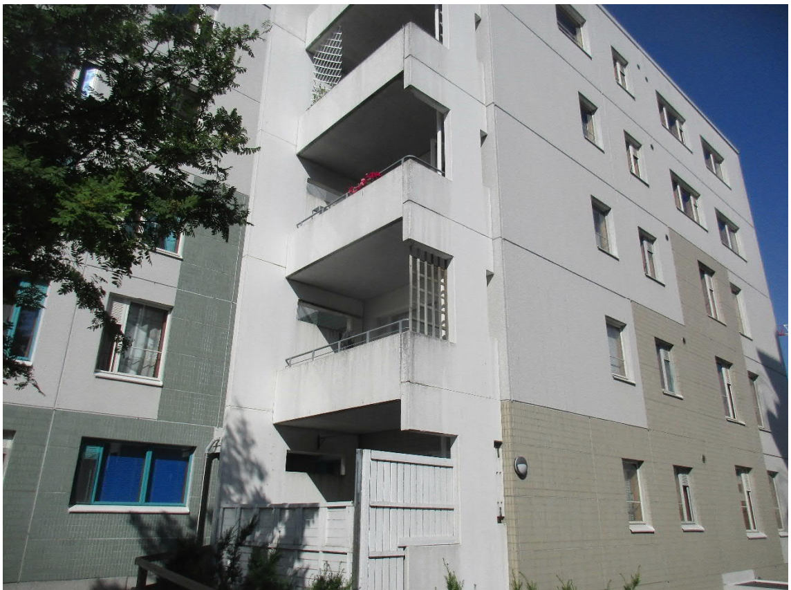
Kuva 2. Tyypillinen 1990-luvun kerrostalo, jossa julkisivuelementtien pintatyypinä on sekä valkobetonia että klinkkerilaattaa (A-Insinöörit Oy).
