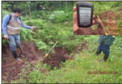
Tubería de descarga que sale de la plataforma K.
