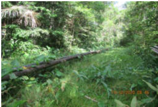
Vista del oleoducto que transporta hidrocarburos desde el campo de producción Capahuari Norte hasta la Estación de Andoas que se superpone con el Sitio S0444.
