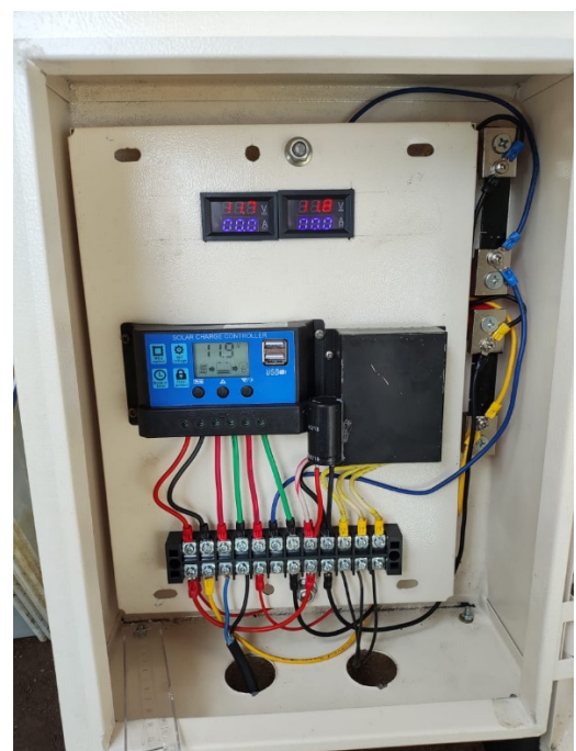
Gambar 7. Sistem Kontrol Kelistrikan
