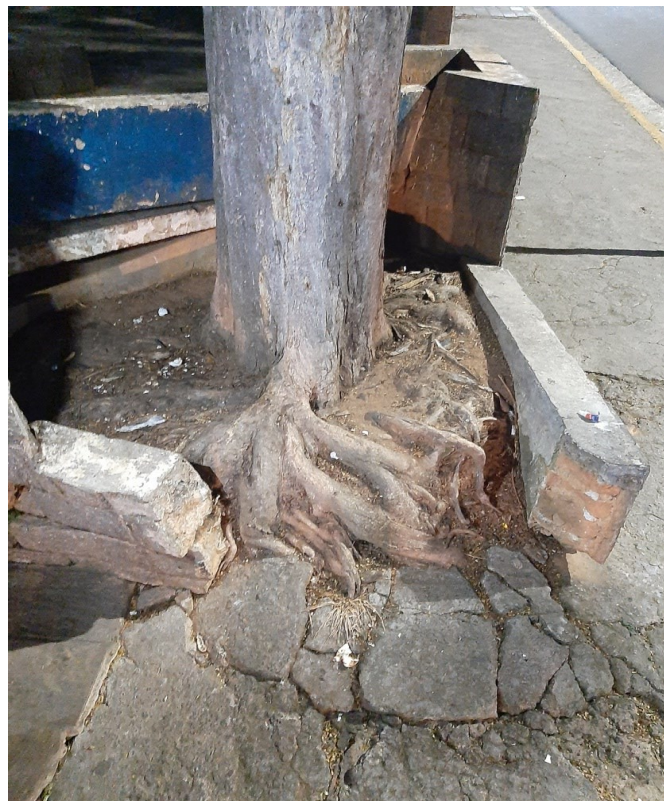
Figura 8. Indivíduo com raiz superficial causando o estouro da calçada e canteiro na praça Capitão Luiz Romão Siqueira, em Cabo Verde - MG
