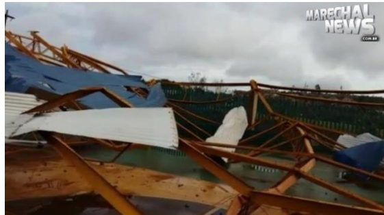
Figura 13: Cobertura da Quadra de esportes destruída
