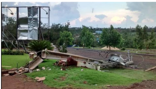
Figura 10: Postes e cabos abaulados
