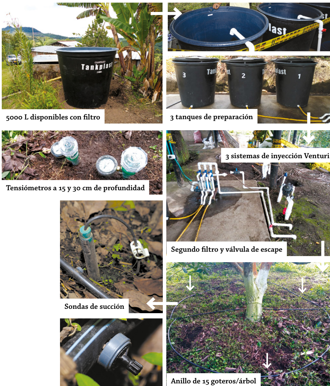
Figura 12. Sistema de fertirriego instalado en la subparcela de aguacate Hass
