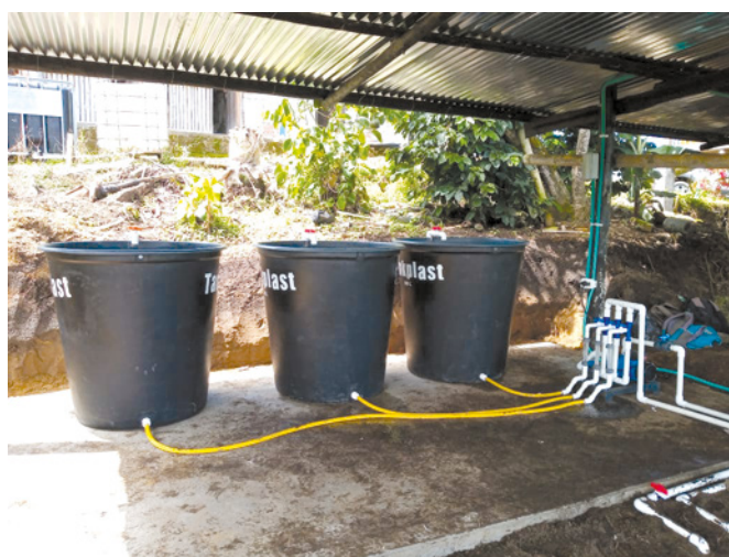
Figura 9. Sistema de fertirriego e inyectores instalados con tanques de fertilización y automatización eléctrica
