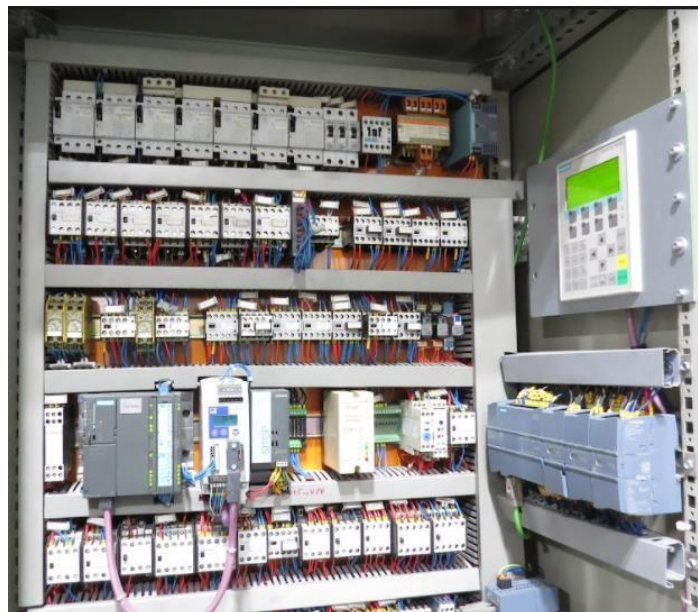
Figura 93. Nuevo sistema de control de la máquina Schuler - 1996 con PLC S7-1200
