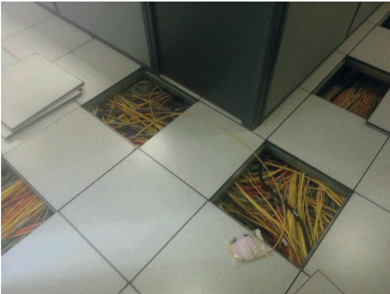
Fig. 1. – Câbles de fibre optique dans les faux planchers du datacenter TH2 en 2014
