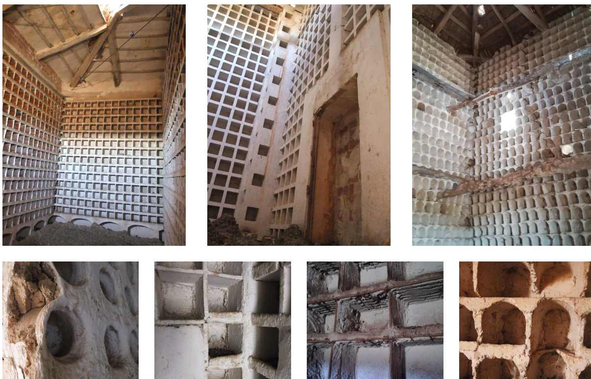
Figura 16. Distintas configuraciones de nichos en el interior del palomar y detalles de construcción con cangilones, moldes de yeso, baldosas y cañas (F. Castilla)
