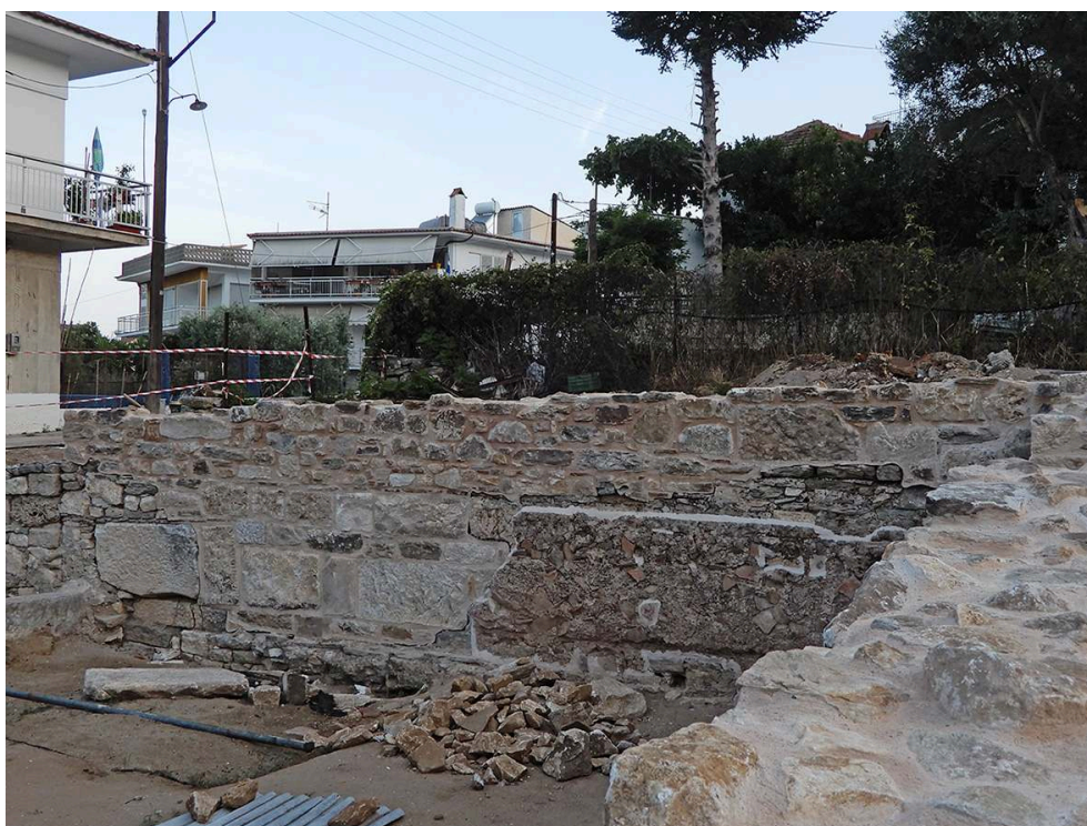
Fig. 21. PCE21, le MUR52 avec la lacune comblée et le mortier du placage consolidé.
