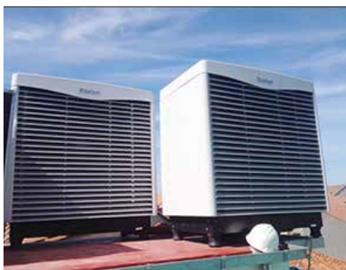
Fig 44. Unidad exterior Aerotermia comunitaria en un proyecto de rehabilitación de Gijón. Fuente: Moris Arroes, instalaciones y proyectos.
