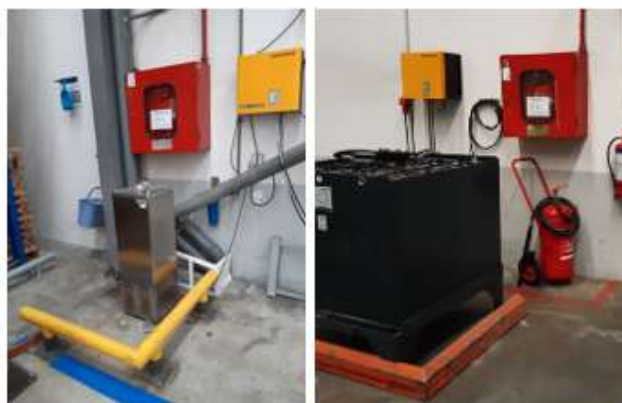
Figura 4.14 - Caixas de carretel obstruídas
