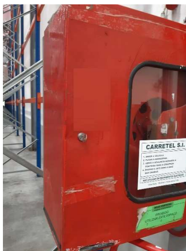
Figura 4.15 - Exemplo de caixa de carretel existente no edifício
