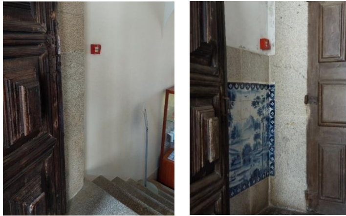
Figura 22 - Dispositivos de acionamento manual de alarme
