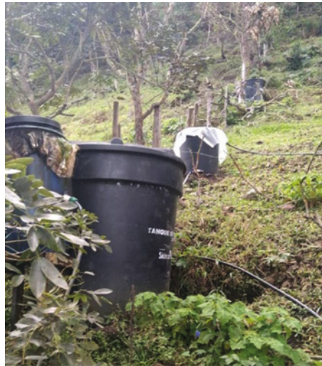
Figura 15. Tanques para la sedimentación y la reducción del caudal en el nacimiento de agua Fuente: elaboración propia. Fotografía: J. Cárdenas (2021).
