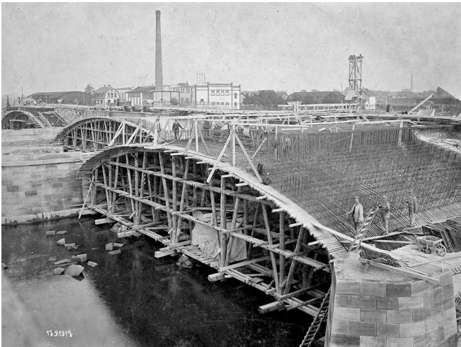
Bild 3 Bau der alten Kanalbrücke: Lehrgerüste Construction of the old canal bridge: falsework
