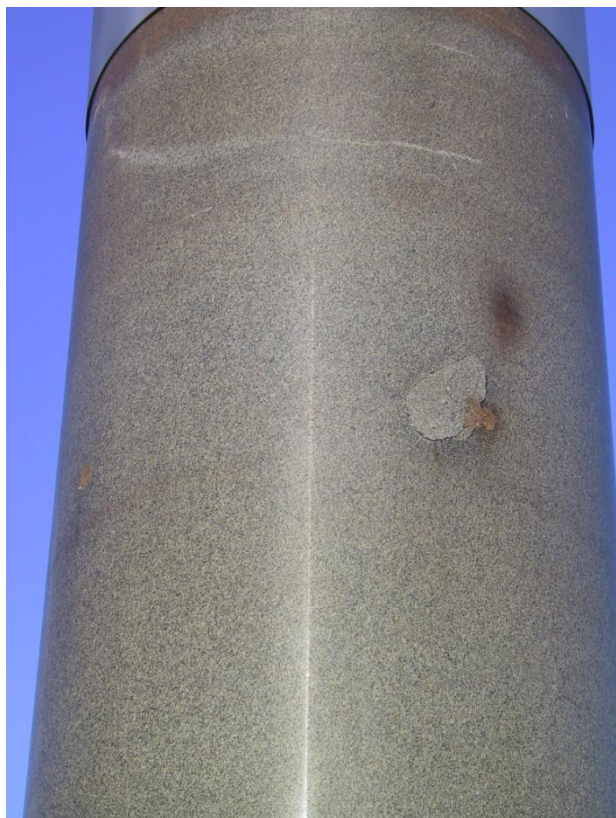
Kuva 3. ”Päänkokoinen” paikka korjatussa kivitelassa, Sapokan vesipuisto. Kotka. Kuva: Olavi Selonen.
