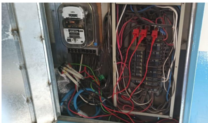
Fig. 32 Instalación del analizador de redes en el tablero de control Fuente: Autor
