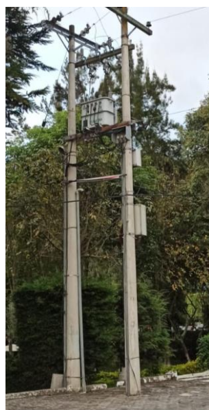
Fig. 22 Transformador de 75 kVA FICA-FICAYA Fuente: Autor
