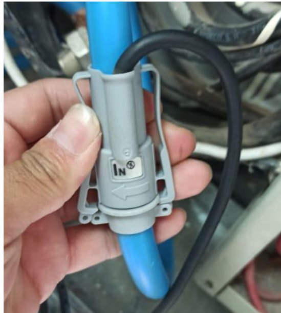
Fig. 31 Instalación de pinzas de corriente Fuente: Autor
