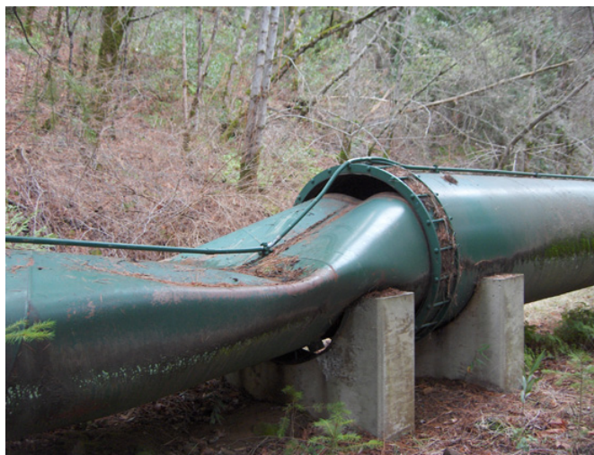
Slika 3: Lom usled izvijanja cevovoda [27]
