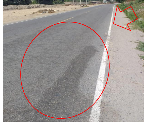
Fotografía: Deterioro dentro de los 3800 m de la prog.16+000, sentido Oeste- Este, se observa deterioro tipo B (Afloramiento de agua, código: AA)
