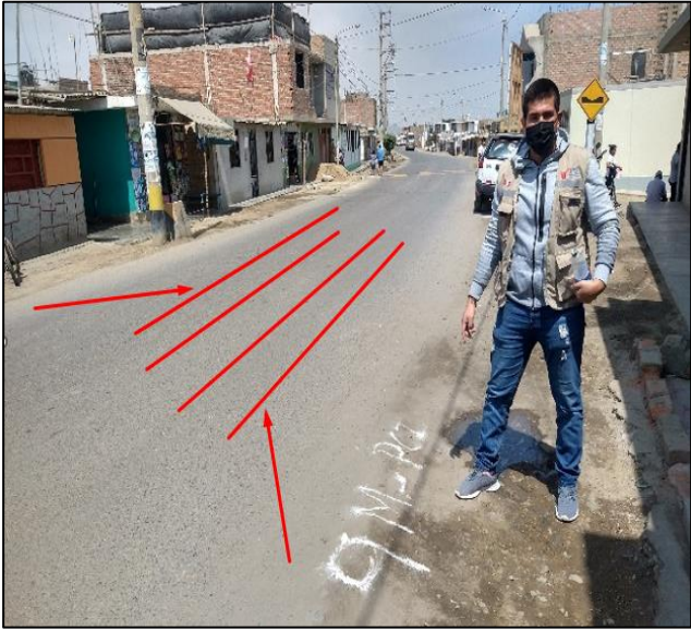
Fotografía: Muestra 1 (punto 9), presencia de exudación en la prog: 13+ 282.4
