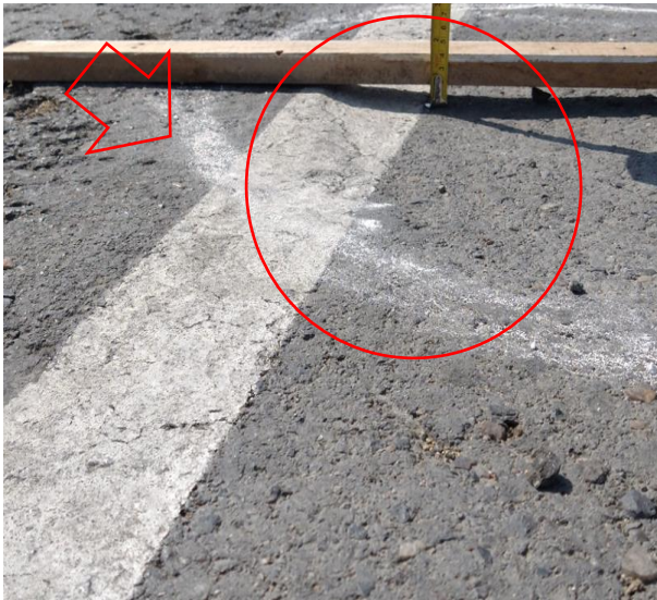
Fotografía: ahuellamiento de baja severidad con una medida entre 13 mm a 25 mm
