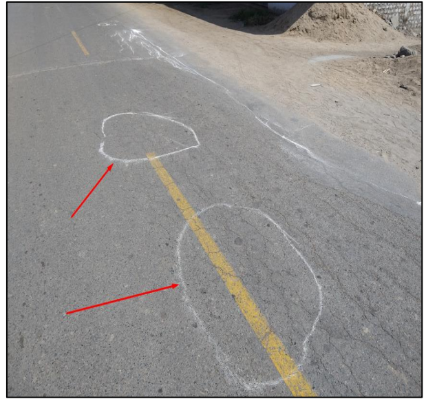
Fotografía: Muestra 2 (punto 18), presencia de piel de cocodrilo en la prog: 13+ 567.9
