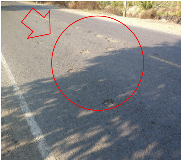
Fotografía: Deterioro dentro de los 3200 m de la prog. 16+000, sentido Oeste- Este, se observa deterioro tipo B (Ojo de pescado, código: O)
