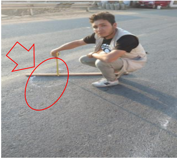
Fotografía: Deterioro dentro de los 200 m iniciales de la prog.13+000, sentido Oeste- Este, se observa deterioro tipo A (Depresiones o Hundimientos longitudinales, código: DL)
