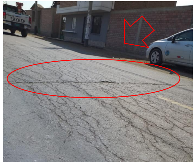
Fotografía: Deterioro dentro de los 300 m de la prog.13+000, sentido Oeste- Este, se observa B (fisura transversal)
