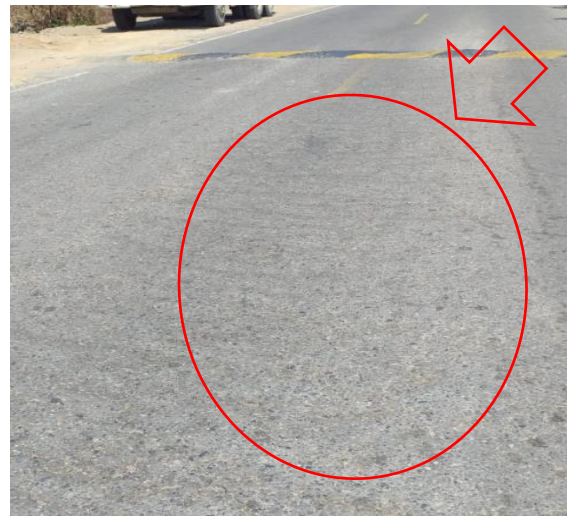
Fotografía: Deterioro dentro de los 3500 m de la prog.15+000, sentido Oeste- Este, se observa deterioro tipo B (Fisuras parabólicas, código: FP)
