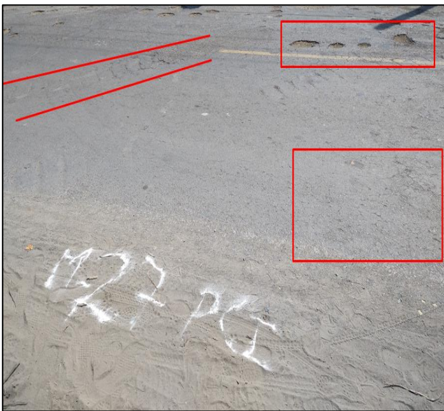
Fotografía: Muestra 3 (punto 27), presencia de exudación en la prog: 13+ 850.5
