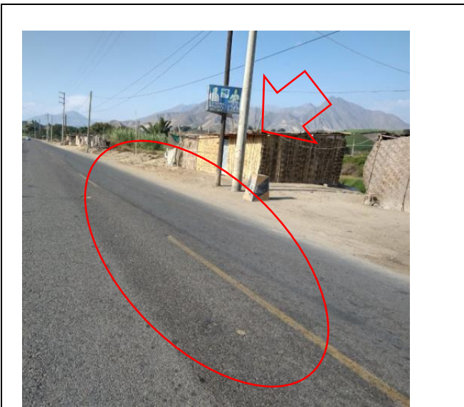
Fotografía: Deterioro dentro de los 2400 m de la prog.15+000, sentido Oeste- Este, se observa deterioro tipo B (Exudación, código: EX)
