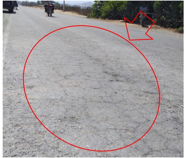
Fotografía: Deterioro dentro de los 200 m iniciales de la prog.13+000, sentido Oeste- Este, se observa deterioro tipo A (Fisura piel de cocodrilo, código: FPC)
