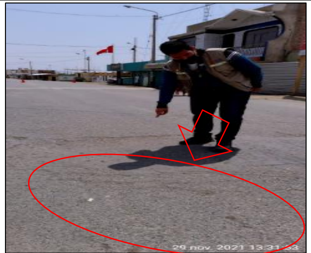
Fotografía: Falla tipo parches
