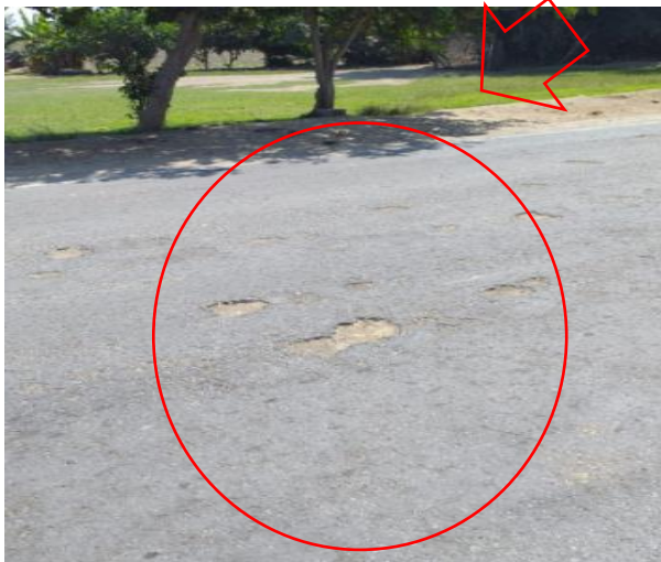
Fotografía: Deterioro dentro de los 3800 m de la prog.16+000, ambos sentidos, se observa deterioro tipo B (Ojo de pescado, código: O)
