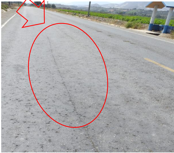
Fotografía: Deterioro dentro de los 3500 m de la prog.15+000, sentido Oeste- Este, se observa deterioro tipo B (Fisura longitudinal por fatiga, código: FLF)
