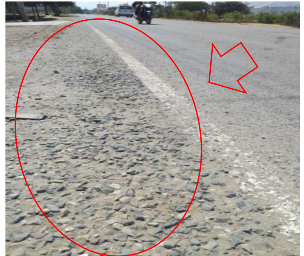
Fotografía: Deterioro dentro de los 3700 m de la prog.15+000, sentido Oeste- Este, se observa deterioro tipo B (Perdida de la película ligante, código: PL)
