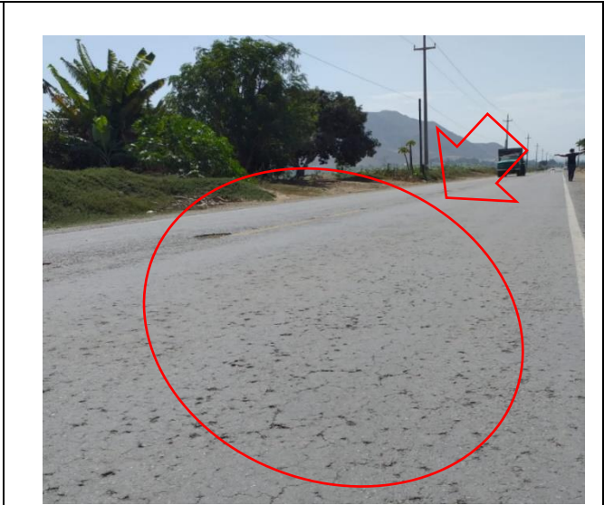
Fotografía: Deterioro dentro de los 1600 m de la prog.14+000, ambos sentidos, se observa deterioro tipo B (Segregación, código: C)
