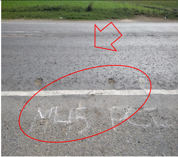
Fotografía: Falla tipo desprendimiento de agregados y huecos
