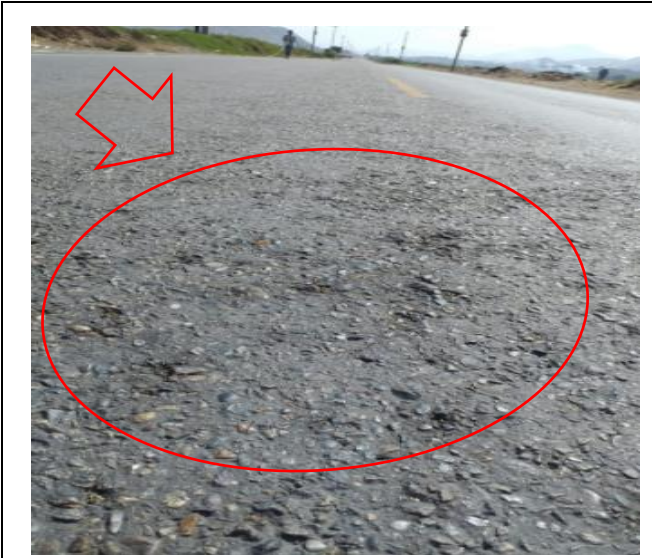
Fotografía: Deterioro dentro de los 1400 m de la prog.14+000, sentido Oeste- Este, se observa deterioro tipo B (Pulimiento de agregados, código: PU)
