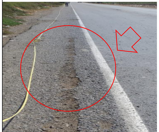
Fotografía: Deterioro dentro de los 4000 m de la prog.16+000, sentido Este-Oeste, se observa deterioro tipo B (Erosión de bermas, código: EB)
