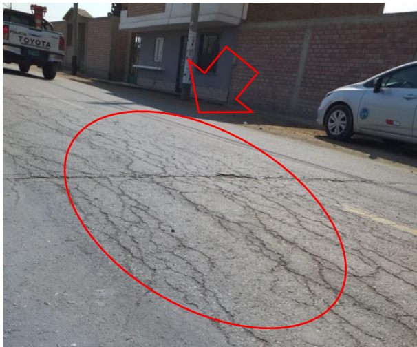
Fotografía: Deterioro dentro de los 300 m iniciales de la prog.13+000, ambos sentidos, se observa deterioro tipo A (Fisura longitudinales por fatiga, código: Flf)
