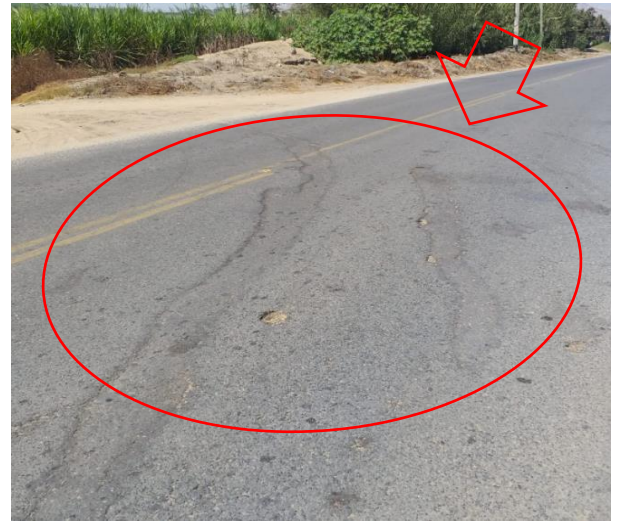
Fotografía: Deterioro dentro de los 3000 m de la prog. 15+000, sentido Oeste- Este, se observa deterioro tipo B (Afloramiento de agua, código: AA)
