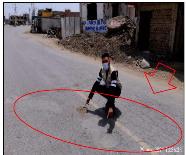
Fotografía: Falla tipo parches y huecos
